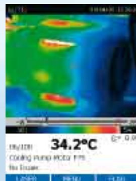
Una bomba de enfriamiento trabajando a su temperatura operativa
